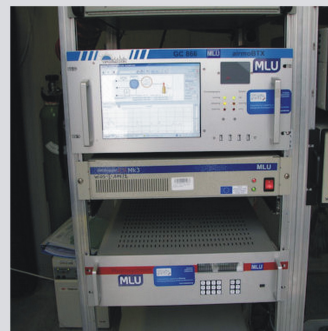
Analizator BTX z detektorem FID Airmo BTX 1000 model 866 z wytwornicą wodoru Hydroxychrom i wbudowanym generatorem powietrza zerowego zakupiony w ramach projektu współfinansowanego z NMF zainstalowany na stacji pomiarowej w Radomiu przy ul. Tochtermana 1
