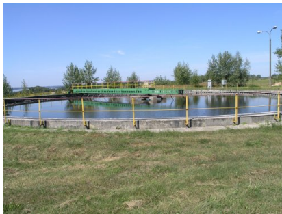
Osadnik wtórny w oczyszczalni w Maszewie
