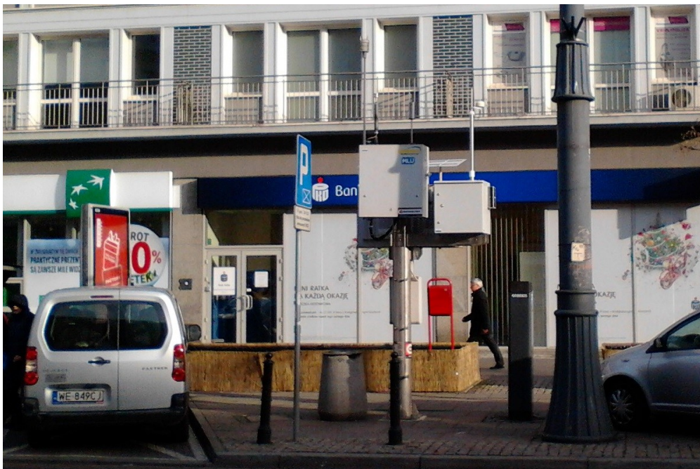
Zdj. 1. Zdjęcie kompaktowej stacji przy ul. Marszałkowskiej w Warszawie
