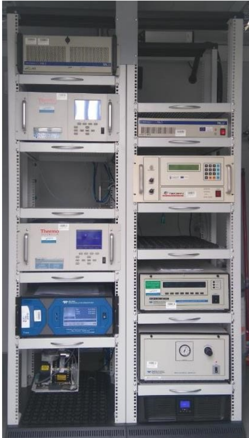
Zdj. 4. Wnętrze stacji kontenerowej
