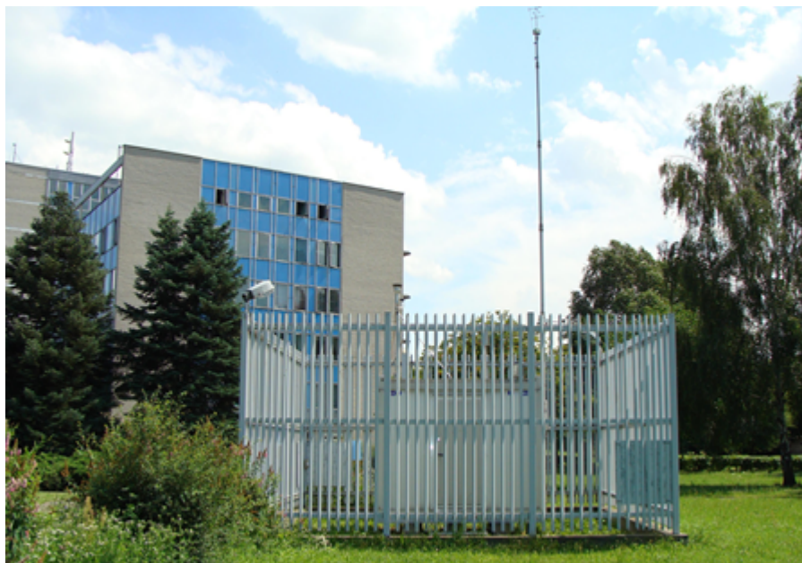
Zdj. 2. Zdjęcie kontenerowej stacji przy ul. Kondratowicza w Warszawie
