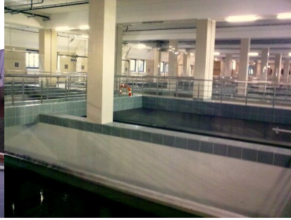
Hala filtrów węglowych
