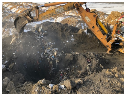
Olszewice - ujawnione odpady
