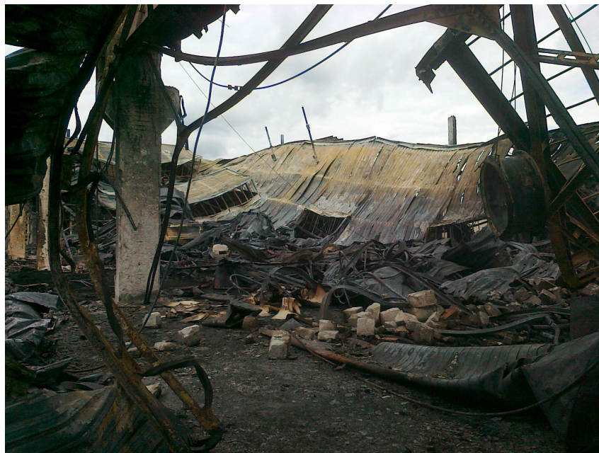
Pożar hali produkcyjnej w wytwórni styropianu w Łochowie
