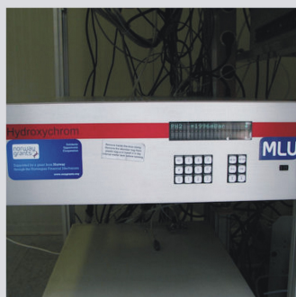
Wytwornica wodoru Hydroxychrom z wbudowanym generatorem powietrza zerowego do analizatora BTX z detektorem FID Airmo BTX 1000 model GC 866 zakupionego w ramach projektu współfinansowanego z NMF zainstalowana na stacji pomiarowej w Warszawie przy ul. Wokalnej 1
